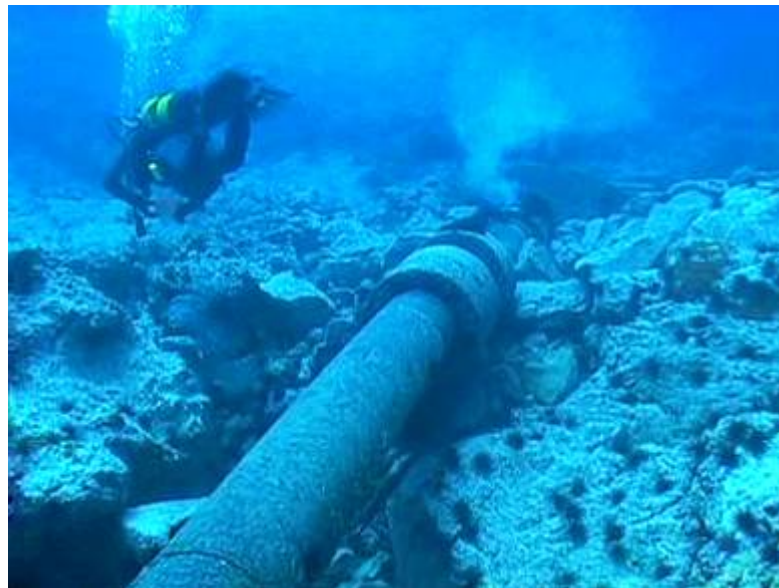
Fig. 4 Escape por rotura del tubo
