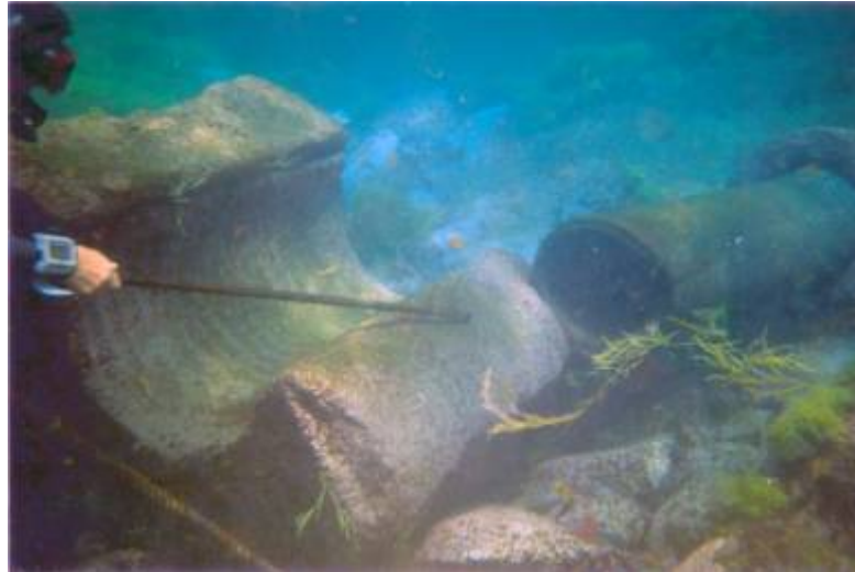
Fig. 3 Rotura producida por el muerto en un temporal
